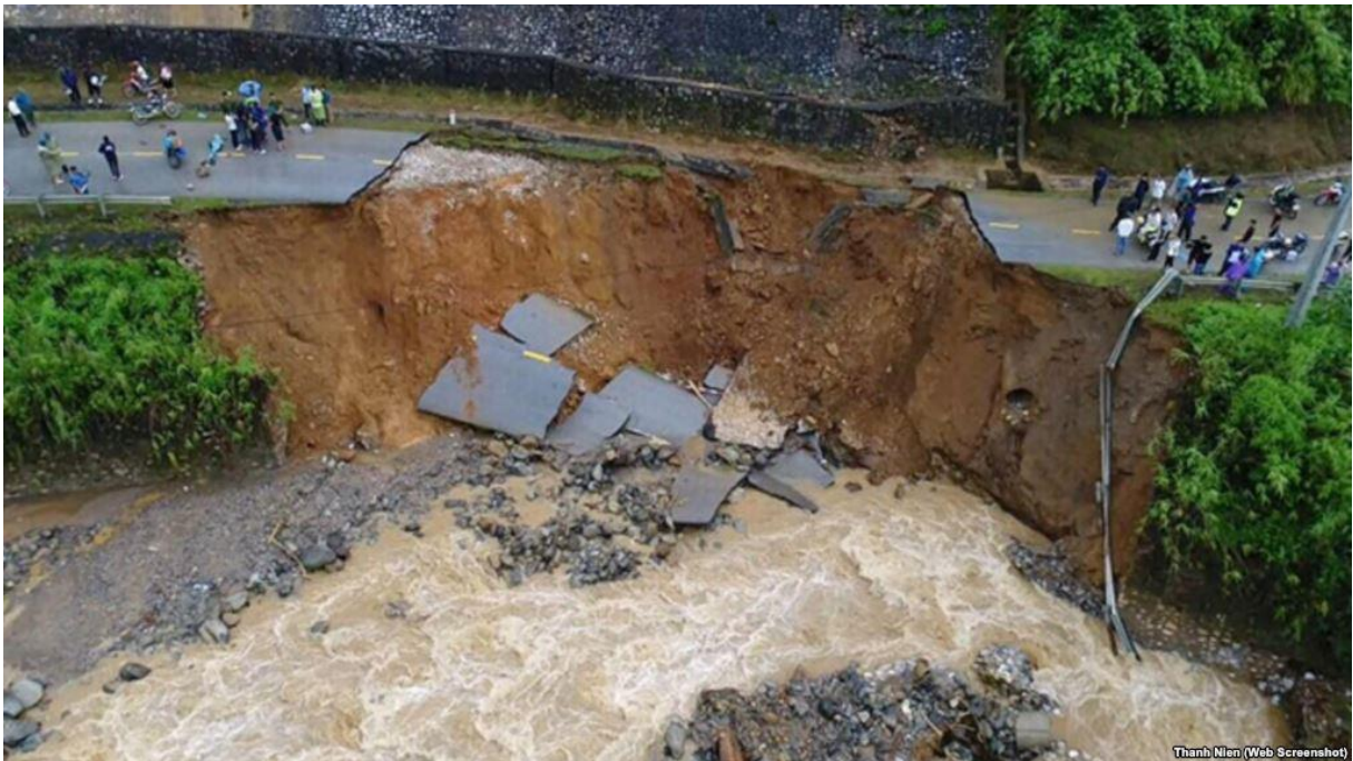
Hình ảnh về một mảng đường Quốc lộ 32 qua huyện Tân Yên, Lai Châu bị cuốn trôi do mưa lũ vào cuối tháng VI năm 2018 ở các tỉnh vùng núi phía Bắc (Nguồn: VOV)
